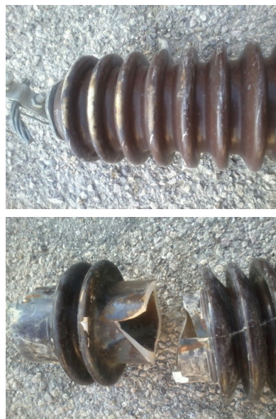
شکل ۱: دو نمونه برق‌گیر معیوب با علامت قوس روی بدنه برق‌گیر.
