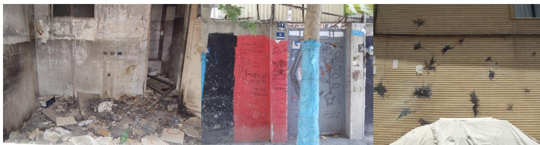
شکل ۸: مشخص نبودن مالکیت رسمی ساختمان‌ها و کوشا نبودن ساکنین در نگهداری از ساختمان‌های خود
