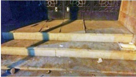
شکل ۱۶- مقابل پله‌های ساختمانی بلا تکلیف
